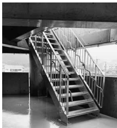
屋上から雨水が降り注ぐ
